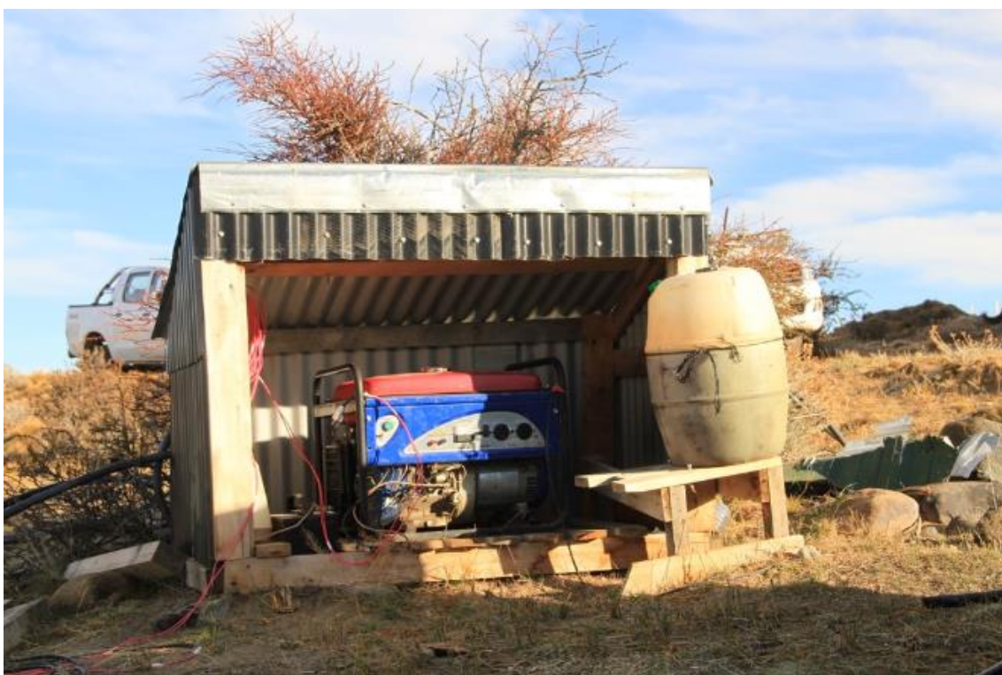
Figura -254: Grupo electrógeno, estancia del AISD.
