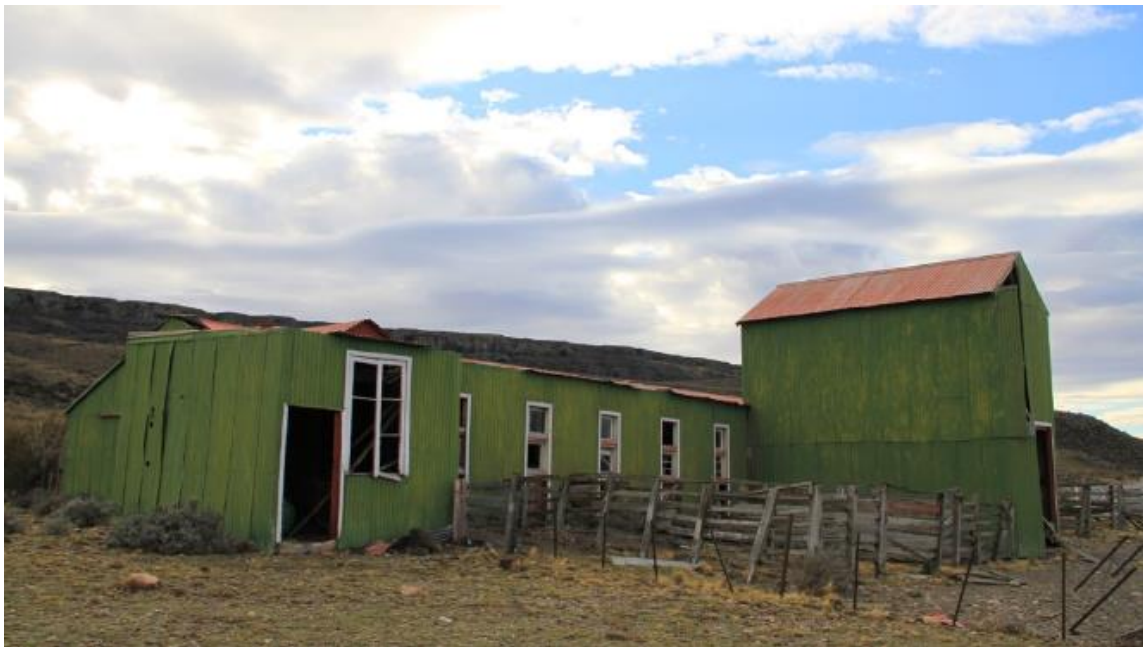
Figura -313. Galpones de esquila en mal estado, Ea. La Barrancosa
